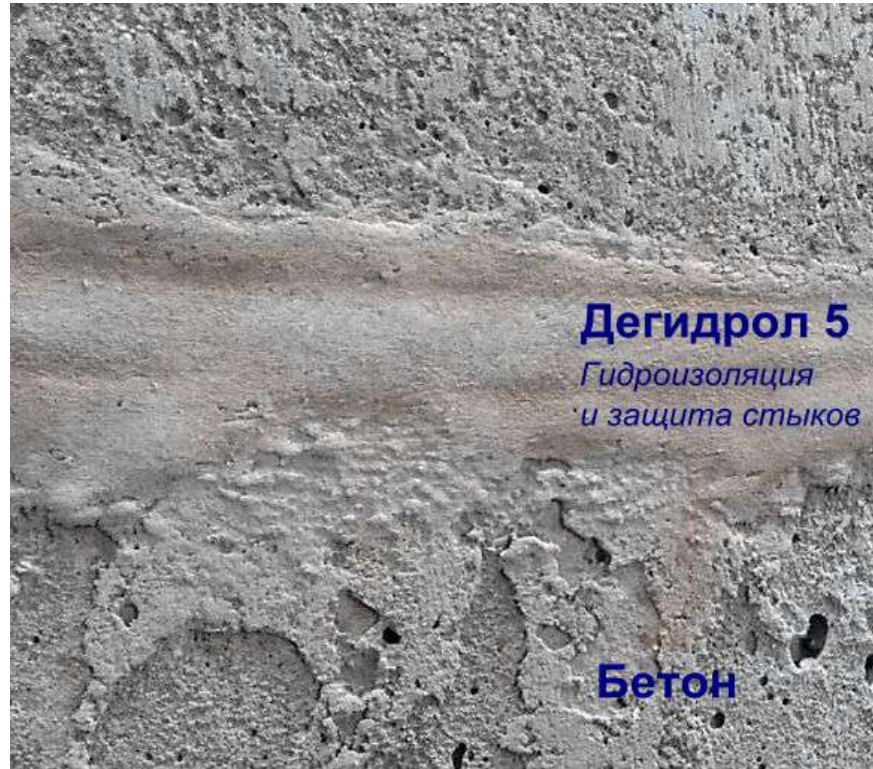
Через год эксплуатации чаши градирни
